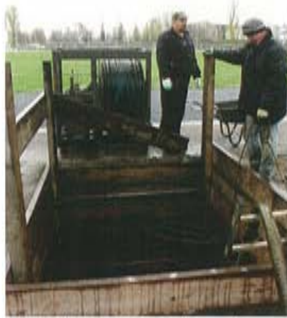
Abb. 5 Kleine Reinigungsbaugrube zur Wasser-HD-Reinigung mit mobiler Schlauchhaspel und Rotordüse mit 1500 bar (Blick von Baugrube 2 in Richtung Baugrube 3)
